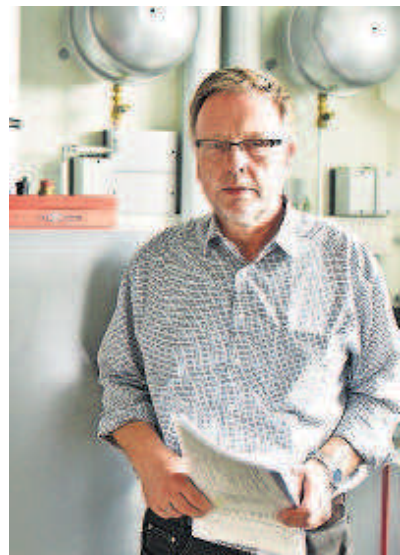
Planer Ulrich Baden zeigt die neue Heizungsanlage im Feuerwehrhaus.
